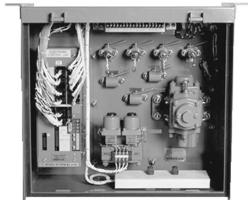
写真2 ブレーキ制御装置
